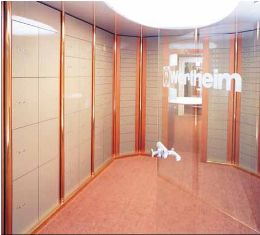
Elektronisch gesteuerte Kundenmietfachanlage in einem Wertschutzraum EET 070
